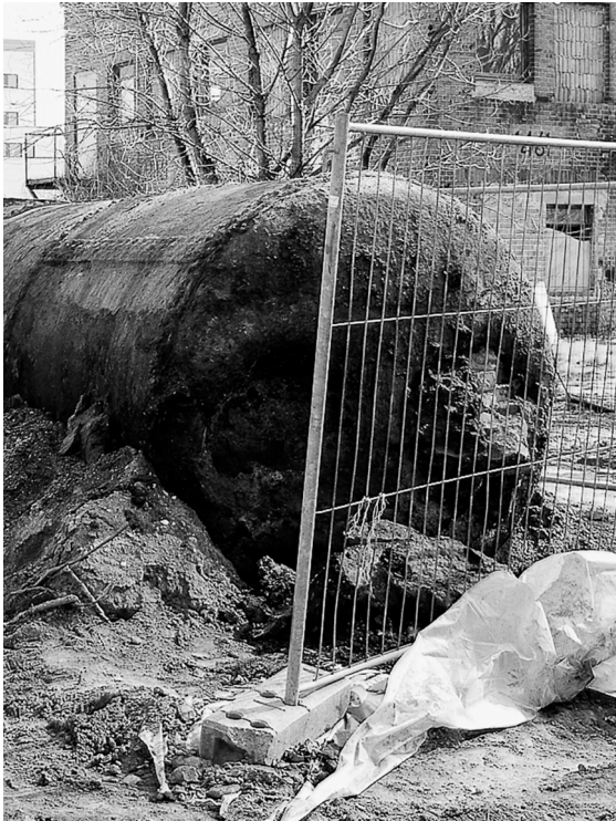
Überraschungsfund eines Teertanks bei der Sanierung des Altlastenstandorts Weißsandt-Gölzau Bild: Alena Bleicher, April 2007
